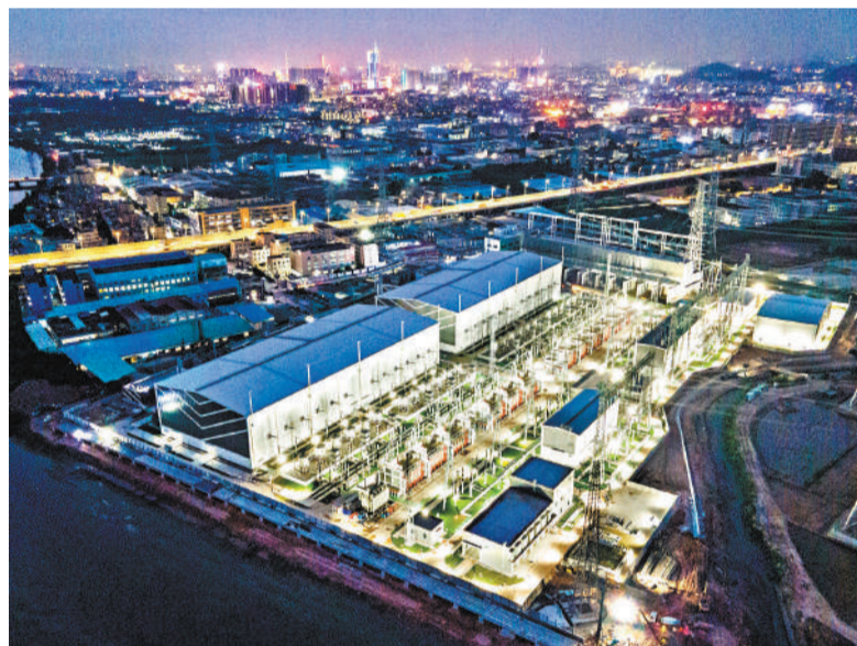
◆夜色中的粵港澳大灣區直流背靠背電網東莞工程。受訪者供圖
