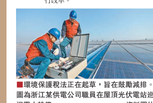
環境保護稅法正在起草，旨在鼓勵減排。圖為浙江某供電公司職員在屋頂光伏電站巡視電力設備。 資料圖片
